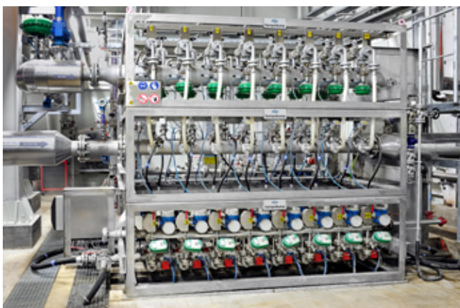
In bestehende Anlage installierter Ecoresinator
